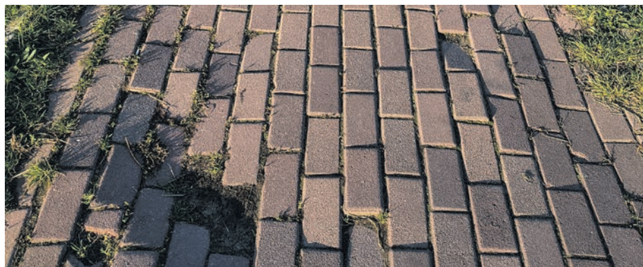
Stary chodnik od dawna wymagał remontu
